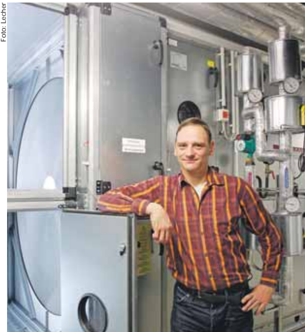
Wärmerückgewinnungsanlagen helfen Energie zu sparen. Andreas Lango, Leiter des Service-Teams auf dem Campus Westend, präsentiert ein Modell der neuesten Generation
